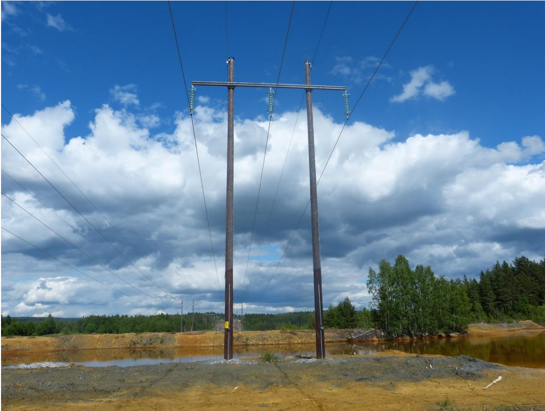
Figur 5. Portalstolpe som planeras i ny ledning. Stolpen på bilden är av kreosotimpregnerat trä, men de planerade kompositstolparna i den nya ledningen kommer att ha samma utformning som denna stolpe.
