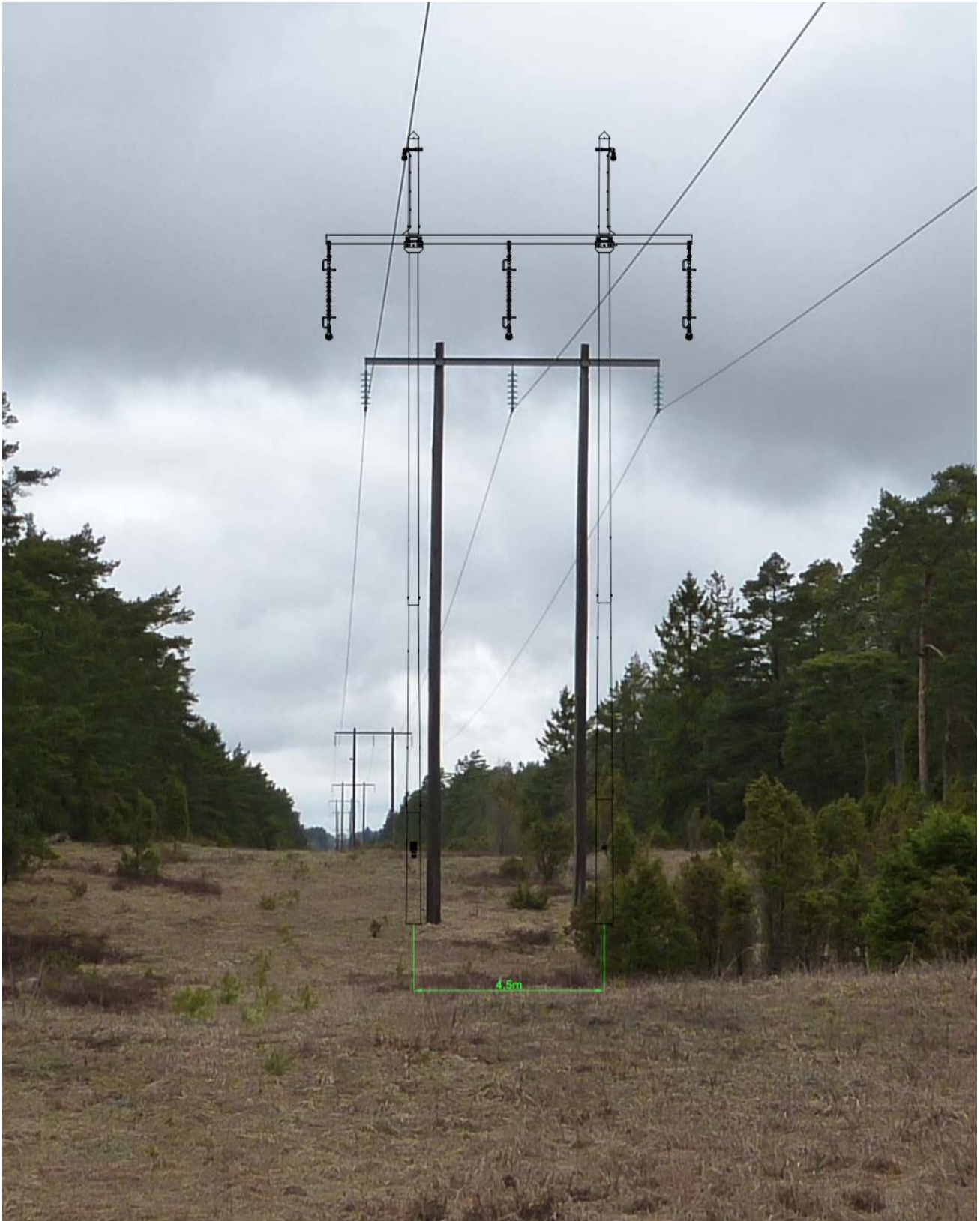
Figur 6a. Bilden visar en jämförelse av en befintlig stolpe med en ny stolpe. Den befintliga stolpen i bilden är cirka 13 meter upp till regeln och cirka 13,5 meter totalt, medan den nya stolpen är 16 meter till regeln och 18 meter totalt.
